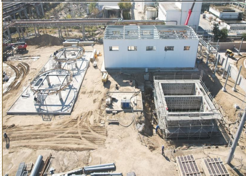
Площадка блоков флотаторов, насосные №3 и 4
