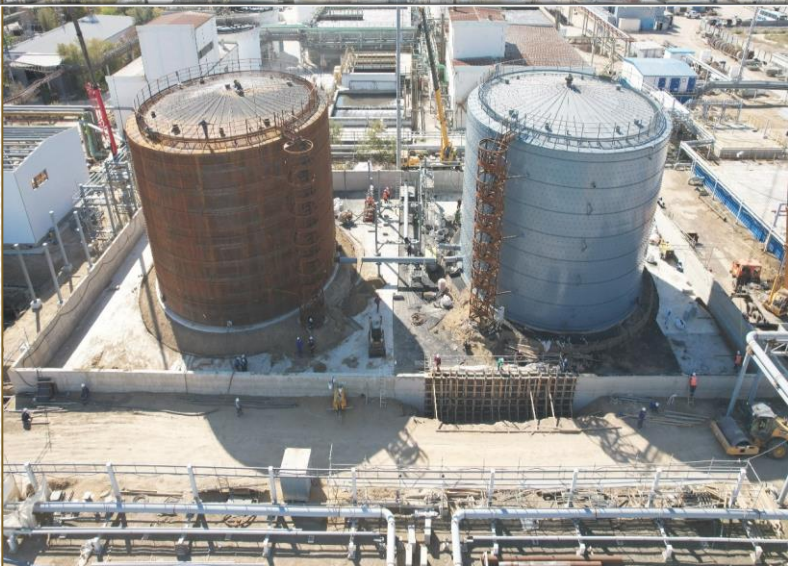
Площадка резервуаров усреднителей V=5000 м 3
